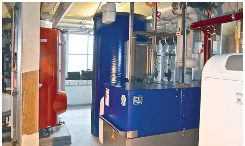
Effiziente Heiztechnik braucht Platz: Nach dem Austausch der alten Anlage ist der Aufstellraum voll ausgelastet. Die neue Heizungsanlage besteht aus einem BHKW und einem modernen Gas-Brennwertkessel.
